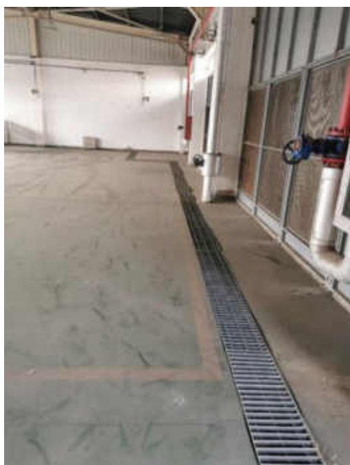
企业危废仓库防渗漏措施
