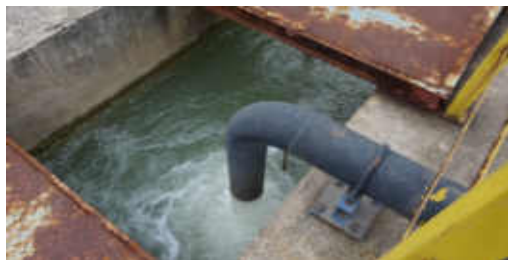
高浓浮沉装置
