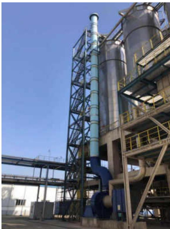
图 4.1-2 PP 项目有组织废气处理措施（布袋除尘器，30m 高 DA005）
